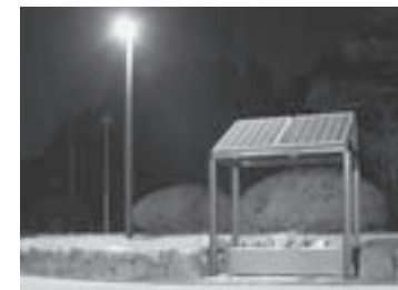
トキ交流会館に設置されたLED街路灯
