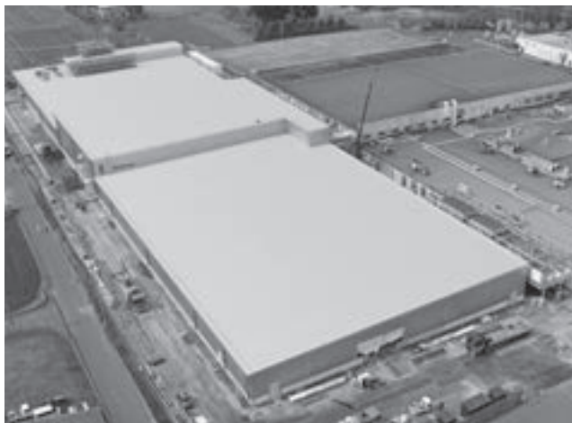
ケミコン東日本株式会社宮城工場に建設中の新工場棟
