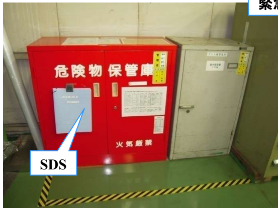
危険物保管庫による薬品管理
