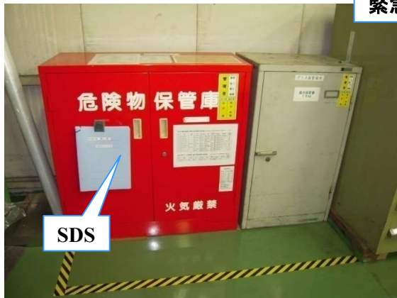
危険物保管庫による薬品管理
